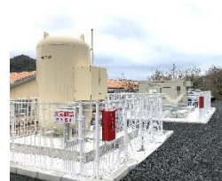
【ガス発電設備】
